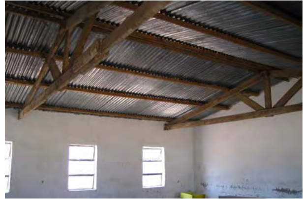
補修を繰り返して使用している教室内部。
