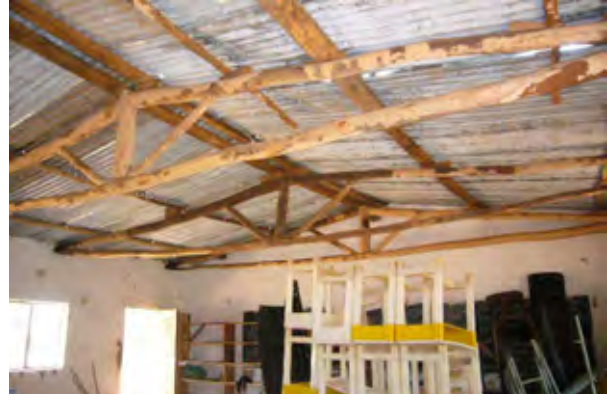
丸太を使用した木トラス。屋根には穴が散見され、雨漏りが問題となっている。
