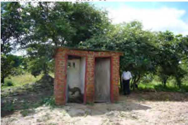
便所棟は中央部が沈下している。地中の便槽壁に対する膨張土の影響が予想される。
