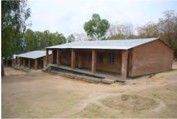
敷地全体が傾斜地であり、降雨時の浸食によって、基礎が露出している。
