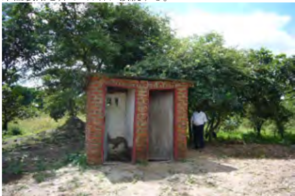
便所棟は中央部が沈下している。地中の便槽壁に対する膨張土の影響が予想される。
