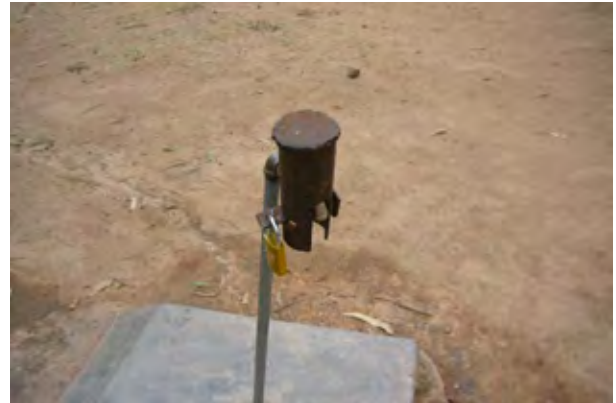
敷地内には市水が引き込まれている。
