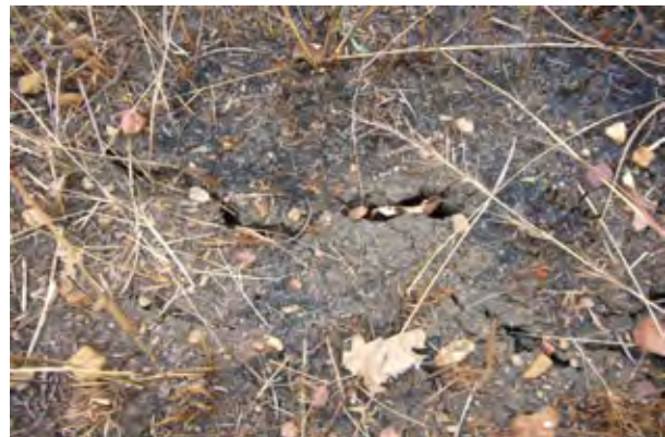
敷地全体が膨張土で覆われている。乾燥により発生したクラック。
