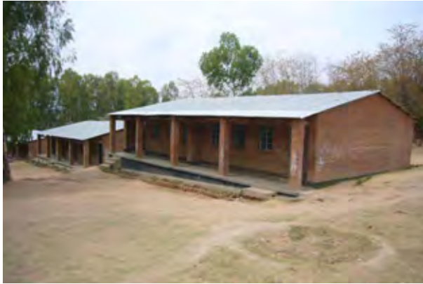
敷地全体が傾斜地であり、降雨時の浸食によって、基礎が露出している。
