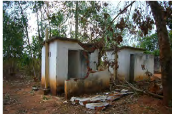
施工品質が悪く、倒壊した便所。
