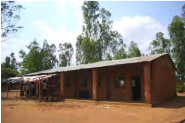
コミュニティ資金により 1974 年に建設された校舎。施工品質は良くない。
