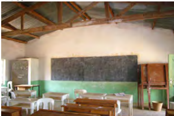
家具が不足している既存教室。木トラスの間隔が大きく、構造的に問題がある。
