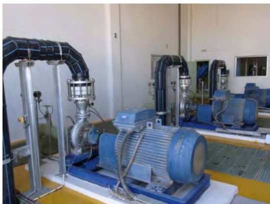
Pompe à haute pression pour la filtration du 1er étage.
