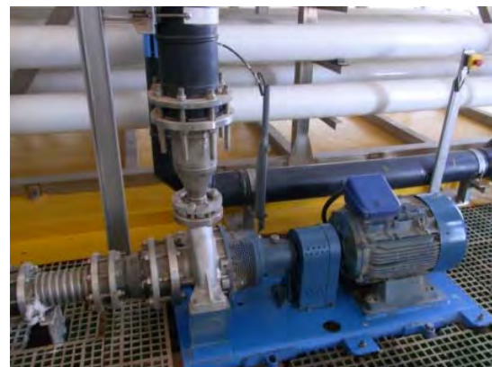
Pompe à haute pression pour la filtration du 2e étage.
