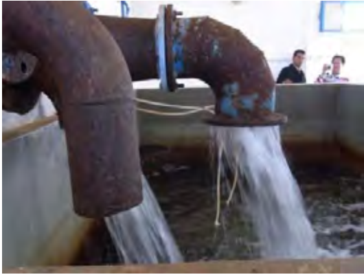
本配水池は塩分濃度が異なる2系統(1.1g/l、3g/l)から導水されており、配水池において混合されている。
