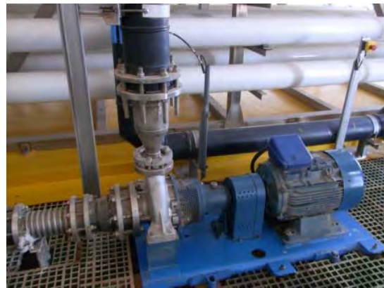
2 段階目に係る高圧ポンプ
