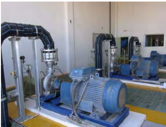
1 段階目の透過に係る高圧ポンプ
