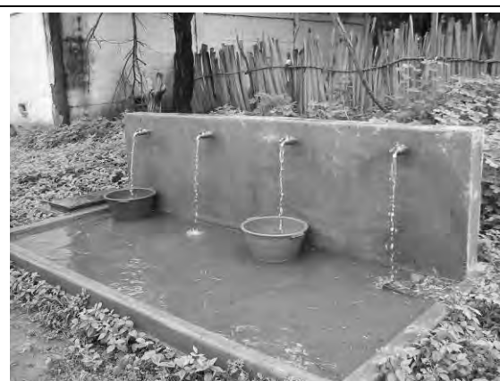
写真-4：R-02 既存公共水栓は清潔に保たれて十分に機能している。(通水試験中)
