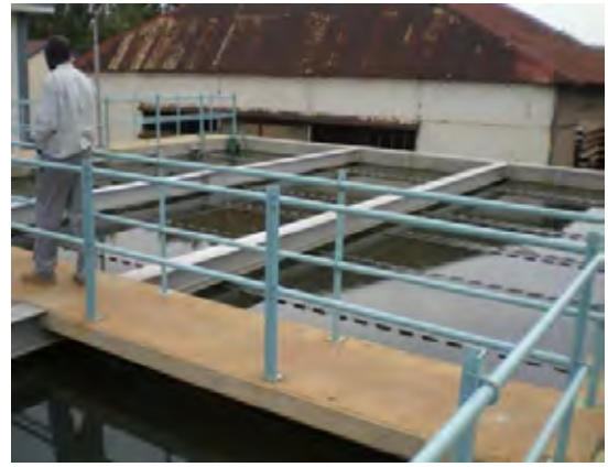
既存浄水場の沈殿地。浄水が適切に集水できていない箇所がある。
