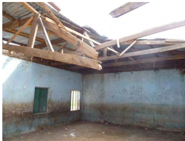
強風により屋根が崩壊した教室。木造トラスの屋根に多く見られる。(48 Alkalawa P.S, Kura LGA)
