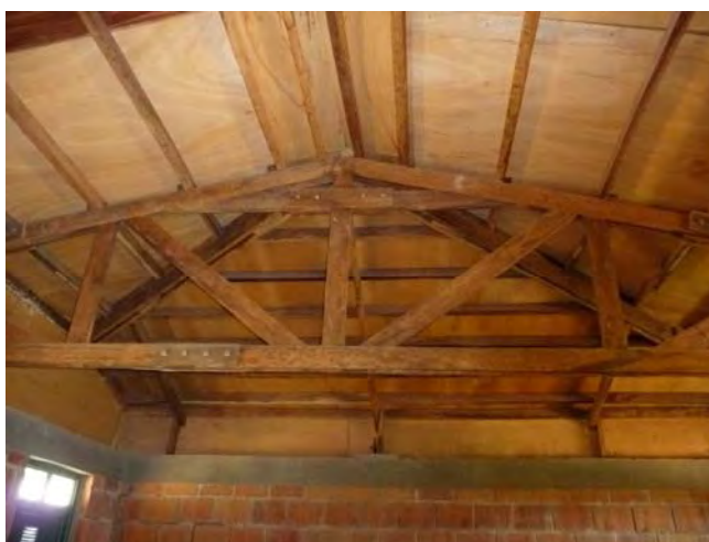
木造トラスによる屋根架構。天井がないことにより、空気が流れる空間が大きいので、教室は快適・開放感のある空間となっている。
