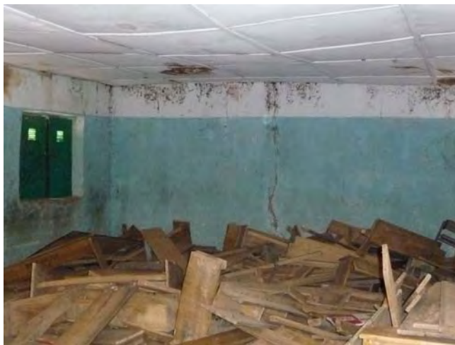
維持管理の不備により、使用不可能となった机・椅子の残骸であるが、日常の管理・修繕等を行っておれば、ここまで状態にはならない。(18 Jalli P.S, Dawakin Tofa LGA)
