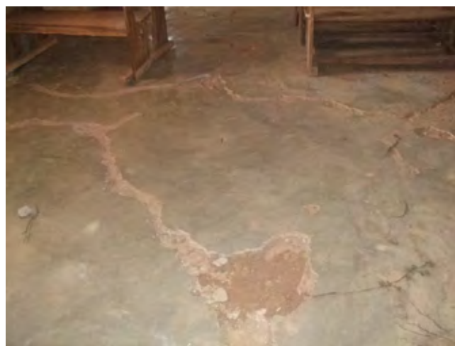
床モルタルは配合が悪いため、剥離・クラックが多く穴が開いた状態で放置されている。(25 Dumbulun P.S, Tsanyawa LGA)
