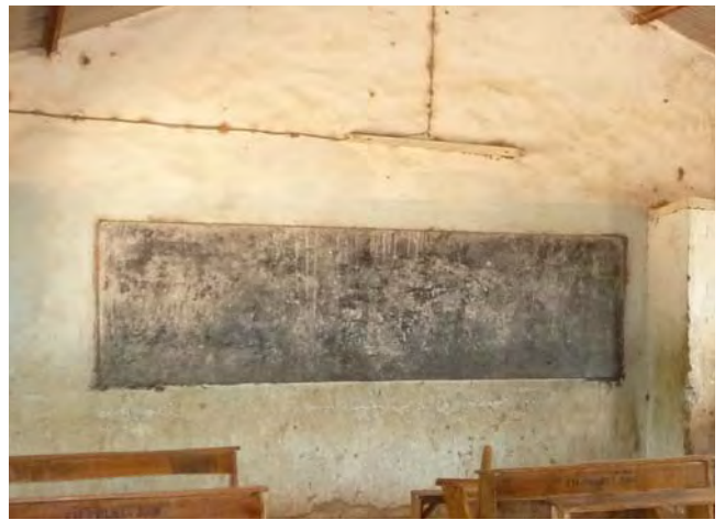
施工品質と日常の管理が悪いため、授業に支障を来たすほど傷んでしまった既設教室内の黒板状況。(33 Dogwa Special, Doguwa LGA)
