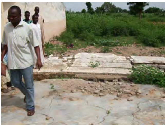
強風で倒壊した壁。基礎はコンクリートではなく、ブロックで造られている (30 Balan P.S, Kabo LGA )
