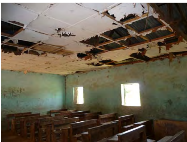
換気が悪いいため、天井は湿気が多く、また、隙間があるため、虫・コウモリ等が入り込み糞害により、悪臭の原因ともなっている。（13 Dedeli P.S, Karaye LGA）
