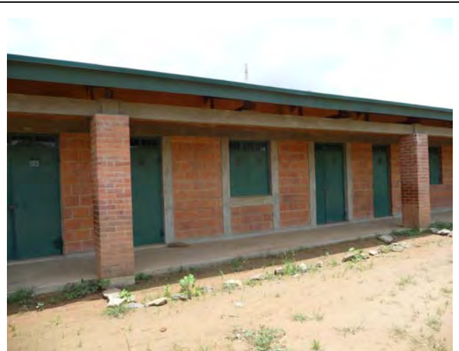
鉄筋コンクリート構造の基礎・柱・臥梁により強固な構造体となっている。
