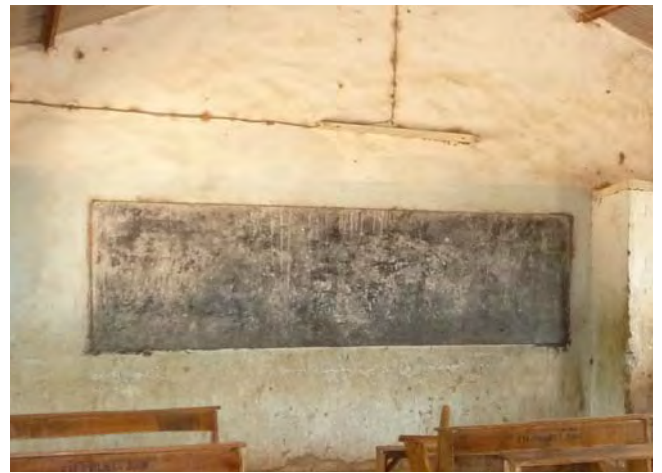
施工品質と日常の管理が悪いため、授業に支障を来たすほど傷んでしまった既設教室内の黒板状況。(33 Dogwa Special, Doguwa LGA)
