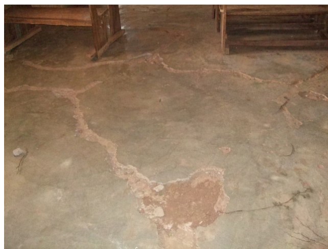
床モルタルは配合が悪いため、剥離・クラックが多く穴が開いた状態で放置されている。（25 Dumbulun P.S, Tsanyawa LGA）
