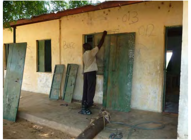
学校職員による建具の補修。学校によっては、維持管理体制が確立されており、日常のメンテナンスが行われている。 (18 Jalli P.S, Dawakin Tofa LGA)
