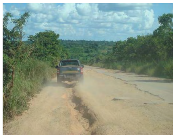
モクバーナンペボ。改修が予定されている国道 1 号線の区間。舗装が剥がれ、道路が洗掘している。
