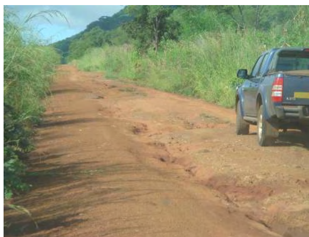
マジジームツアリ。R657 の迂回路として機能している国道 103 号線。未舗装道路であり、洗掘の影響で走行が困難な区間がある。
