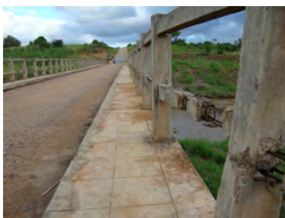
写真 1 ムリケラ橋 コンクリート高覧破損
