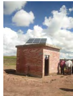
太陽光パネル併設型ポンプ
