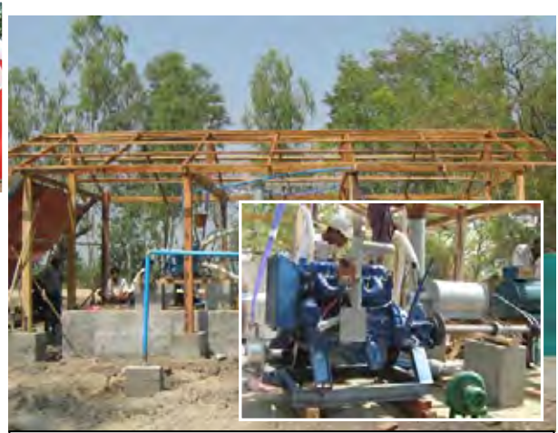
籾殻発電建設・運営プロジェクト (Mon Taw Gyi 村) : 籾殻を薰炭状に燃やした時に発生するバイオガスを利用してエンジンを駆動し、発電機を回す構造になっている。
