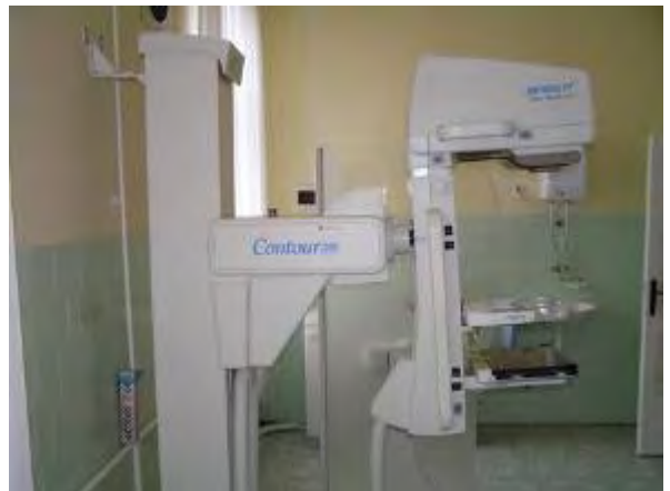
HC-02 Health Centre Senta マンモグラフィ装置 老朽化し修理費用が負担となっている
