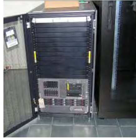
HC-04 Health Centre Valjebo 病院のデジタルデータを格納するサーバー管理室
