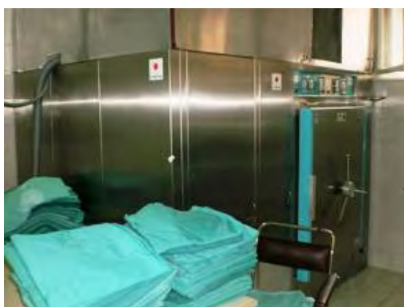
CC-Vojvodina (Novi Sad) 高圧蒸気滅菌装置 適切にメンテナンスされている
