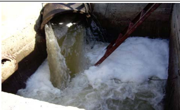
15. Shurafah ポンプ場、吐水槽（ポンプ運転時）
