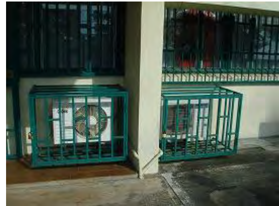
エアコン室外機の防護柵
