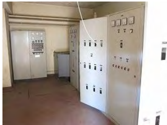
CHUK 電気室 1 内部
