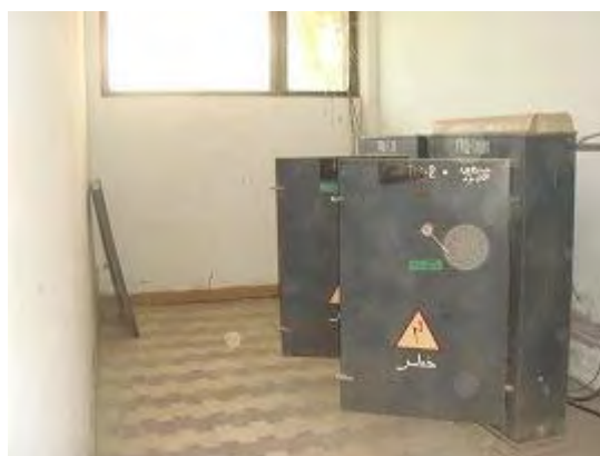
B 棟低圧分電盤
