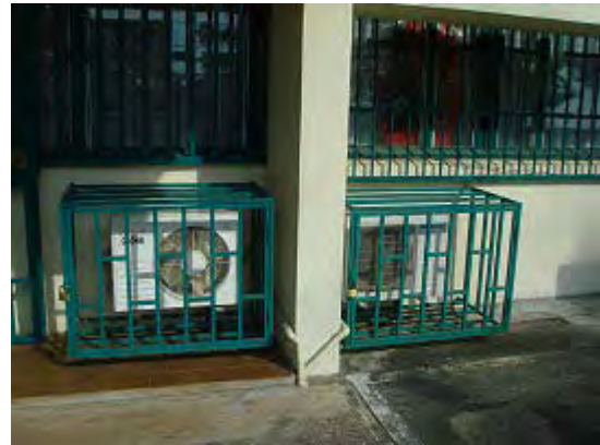
エアコン室外機の防護柵
