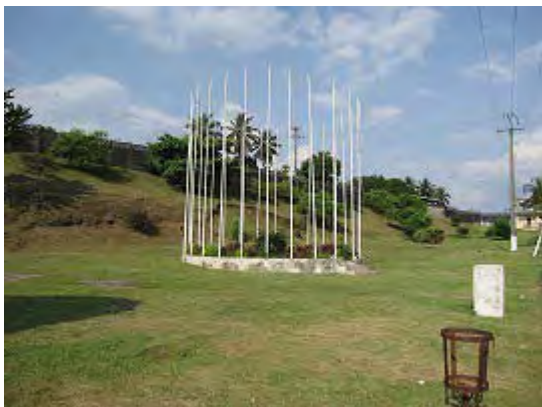
PV モジュール設置箇所 1
