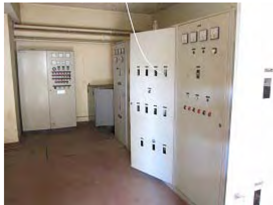
CHUK 電気室 1 内部
