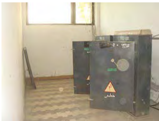
B 棟低圧分電盤
