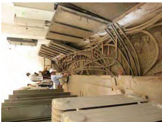
ケーブルピット
