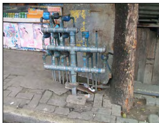
図 II-24 取出管の接続状況
