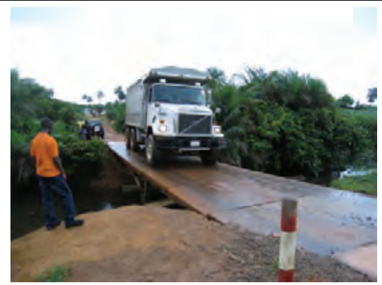
No.9 にて 大型車が頻繁に通行する。通行すると既存 橋梁は大きくたわみ危険な状態である。
