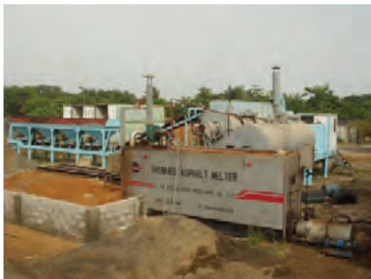
写真 6 - 3 MPW のアスファルト製造 プラント
