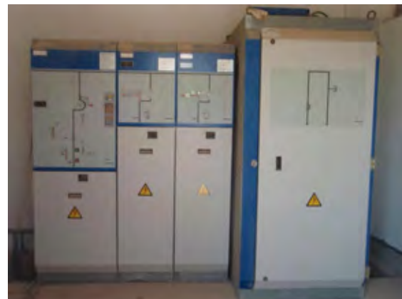
写真-5 : JDECO 既存開閉器。想定容量は 650kVA まで取出し可能。左から 2 番目は予備ユニットとなる。
