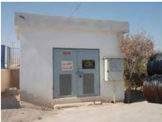
写真-4 : JDECO 既存開閉所。再生鋼加工工場建物のゲート付近にあり、配電線末端鉄塔より地下埋設ケーブルにて引込んでいる。
