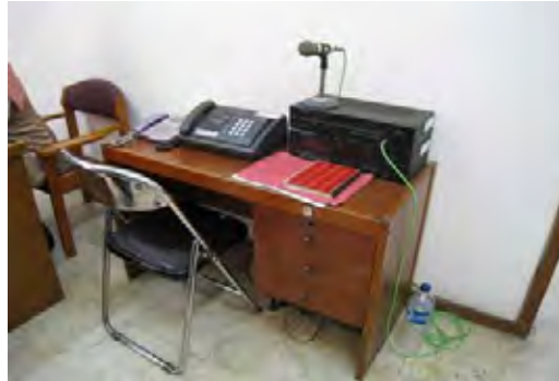
電話、インターホン、放送設備機器 (本館1階の秘書室に機器が設置。)
