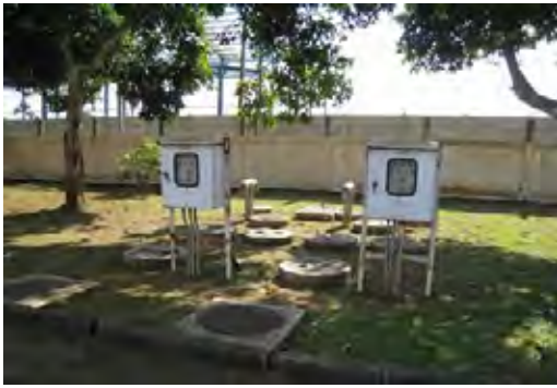
計画サイト東側の浄化槽エリア (排水ポンプで塀裏側の水路に排水。)
