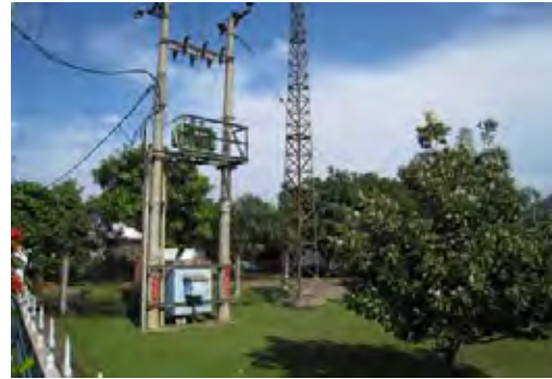
PFIの既存受電変圧器：容量100kVA (地中埋設ケーブルで本館分電盤に送電。)
