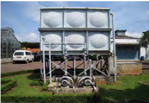
深井戸、受水槽 (18t) 揚水ポンプ (20年前の給水設備で、故障の可能性あり。)
