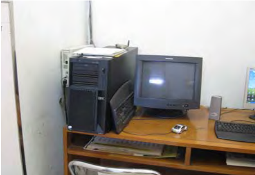
高速通信ケーブル用機器、サーバー (本館1階の秘書室に機器が設置。)
