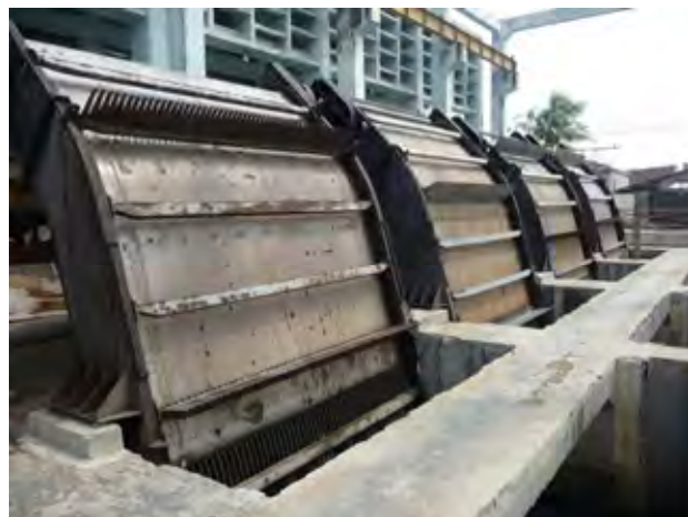
I ⑥. 除塵機 (P-6) 鋼製設備全体に腐食が進んでいる
