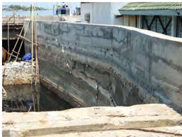
Ⅲ④. 東排水機場排水路2 (P-12) 排水路壁は多くの箇所ではひび割れが生じている。
