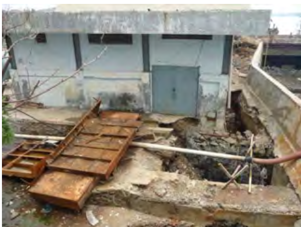
IV③. 電気室(中央・東排水機場用) (P-15) 既存電気室の南東角基礎下は東排水機場のパイピングにより土砂流出を起こしている。
