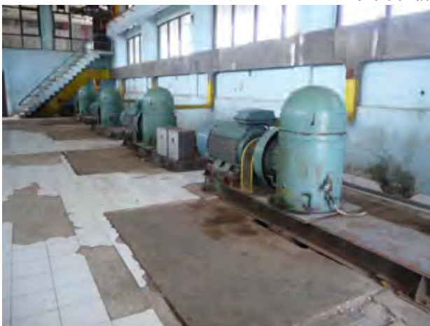
I ③. 東排水機場ポンプ室 (P-3)
