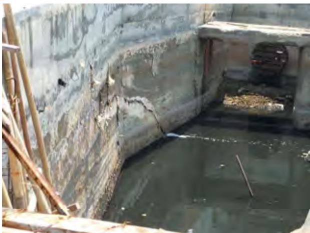
Ⅲ③. 東排水機場排水路1 (P-11) 排水路壁にひび割れが生じている。
