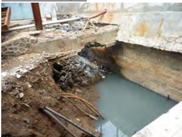
III ①. 東排水機場排水路の左側 (P-9) 排水路のコンクリート壁のひび割れから流出した海水がパイピングにより東排水機場建屋の底版下を抜けて調整池へ流入している。
