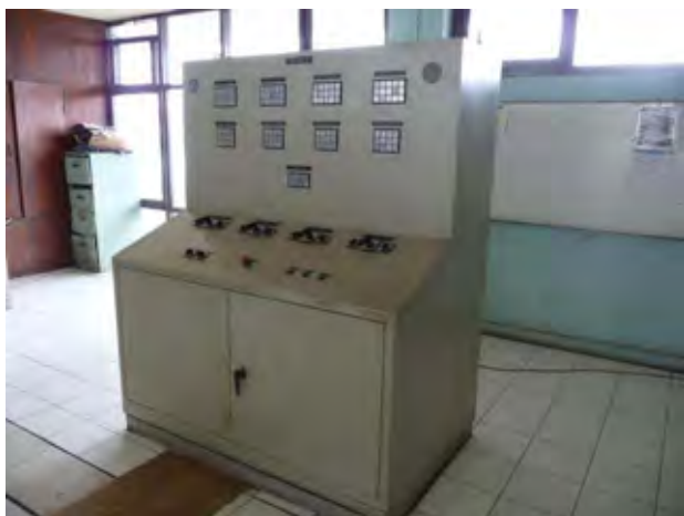
I ⑤. 東排水機場 2 階のポンプ操作盤 (P-5) 東排水機場 2 階に設置されている。
