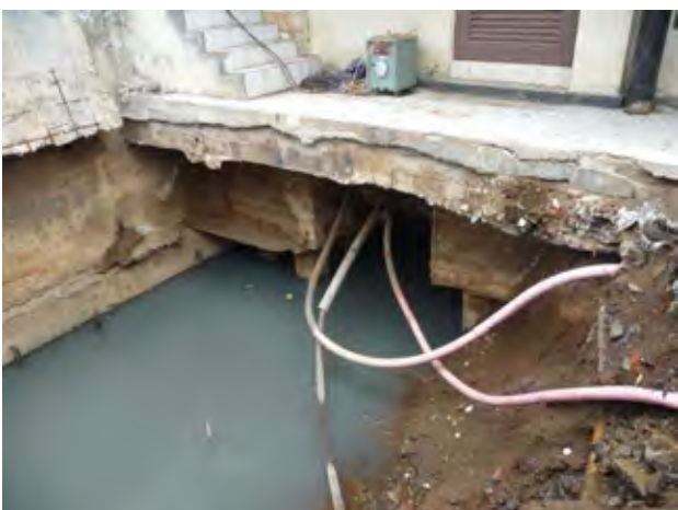
III ②. 東排水機場建屋底部 (P-10) 排水機場建屋底部へのパイピングルート入り口。建屋底版の下がパイピングの結果空洞になっている。
