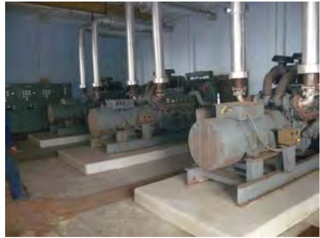
IV⑥. 非常用発電機室内部 (P-18)
