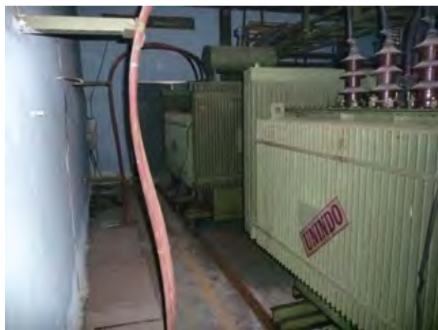
IV④. 電気室内部 (P-16) 変圧器3台と、電気パネル等から構成されている。内部に照明がないため、非常に暗い。また、設備の老朽化も進んでいる。
