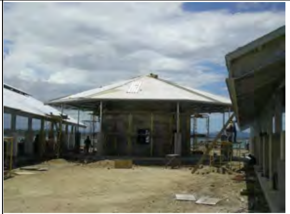
キオスク全景。外壁の塗装前下地処理作業及び屋根工事を施工中
