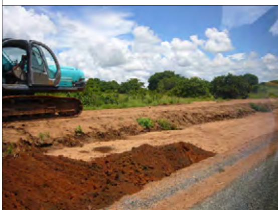
豪雨によりほとんど埋まってしまった土側溝
