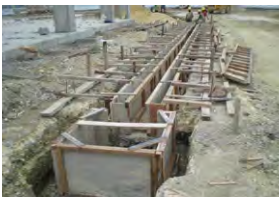
排水溝の施工状況（市場棟Ⅱの脇）、集水枘、U字溝の型枠設置工事の進行状況
