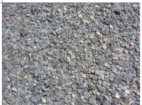
補修対象となった表層。1 層目の碎石 (20mm) が見え、2 層目の碎石 (10mm) が浮いている。
