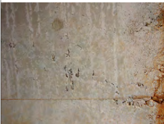
ボックスカルバートのコンクリート表面。少しあばたが見られる。型枠が僅かにずれたところも見られた。
