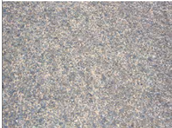
(参考) Unity Bridge 道路の簡易舗装。見た目はこちらのほうが良好である。
