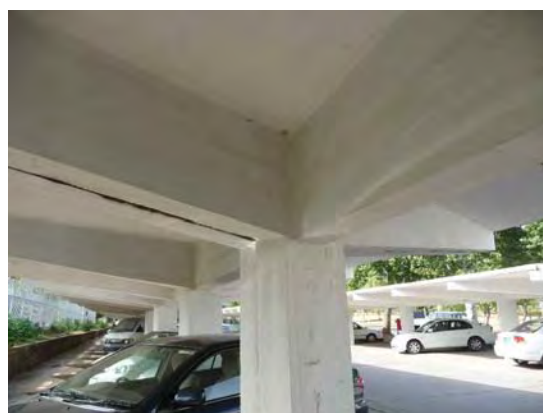
写真 2: 計画委員会駐車場屋根支柱。支柱の強度が確認できないため、別に支柱を建てる計画である。
