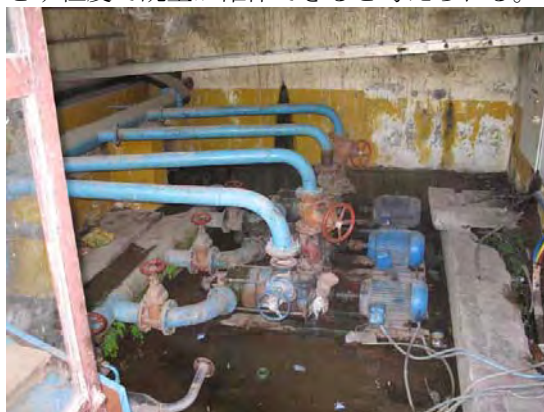
写真 6: スンダリガット浄水場ポンプ。太陽光発電システムによる電力供給を受ける予定である。
