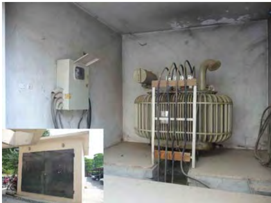
写真 7: 技術委員会敷地内の既存の変電施設。太陽光発電システムと接続される予定である。
