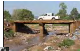
橋梁 No.6 : 老朽化しており、幅員が狭い
