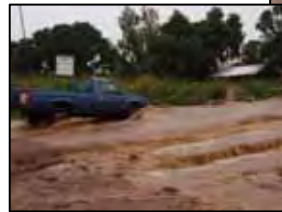
橋梁 No.12 : 強雨時にオーバーフロー
