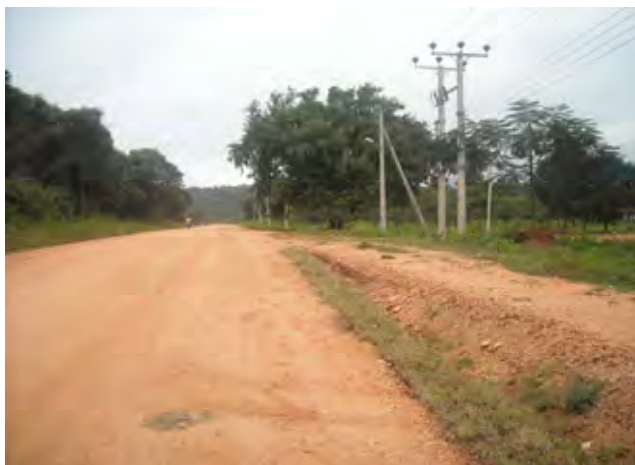
日付：2010年2月16日 場所：モラガハカンダ・ダムサイト 標題：付替え道路沿いの33kV送電線
