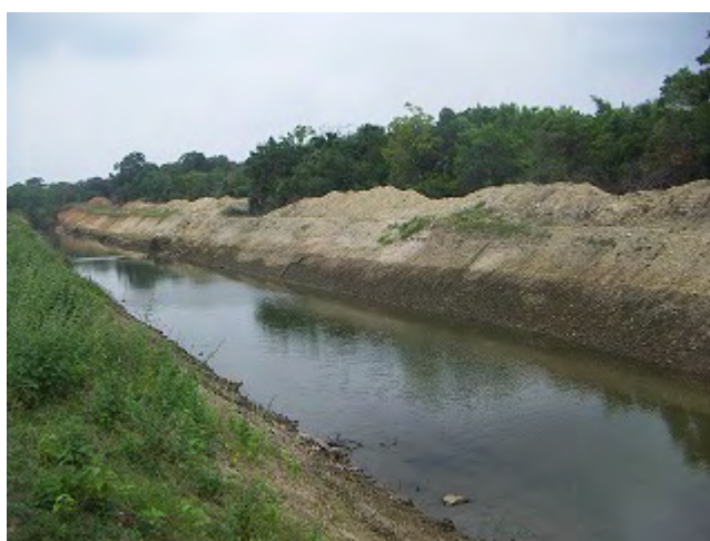
日付：2010年2月3日 場所：カウドゥラ左岸地区 標題：カウドゥラ左岸幹線用水路 拡張工事
