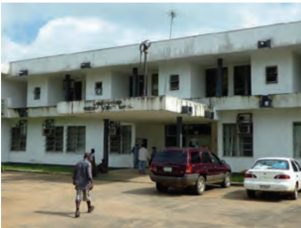
リベリア・日本友好母子病院（LJFMH）正面（大統領の指示で黄色から白色に塗り替えられた壁はカビが目立つ）。
