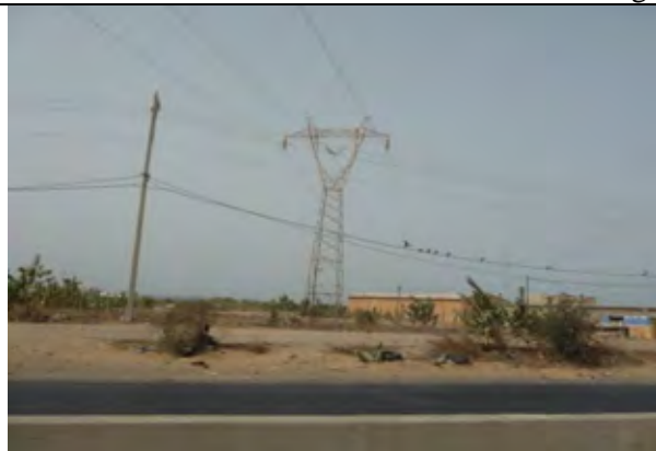
Lignes de transport d'électricité de 225kV Lignes de transport d'électricité de 225kV qui relie la centrale hydroélectrique de Manantali à Dakar
