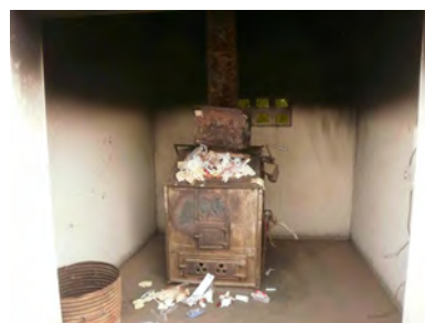
Incinérateur dont la capacité d'incinération est insuffisante
