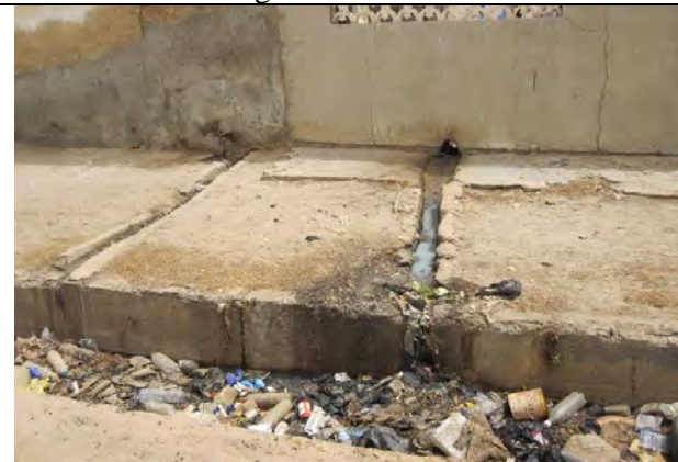
Caniveau d'écoulement des eaux pluviales dans la ville de Kaolack Des déchets solides bouchent le caniveau et des eaux usées ménagères se déversent.
