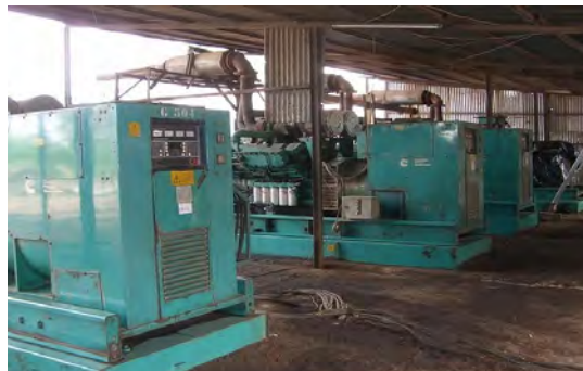
Situation à l'intérieur de la centrale de Tamabounda
