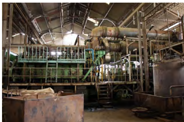
Situation à l'intérieur de la centrale de Bel-Air
