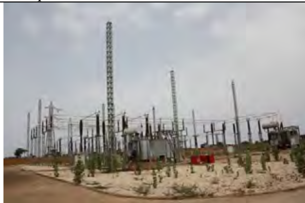
Poste de transformation de Mbour Situation du poste de transformation recevant l'électricité en 90kV
