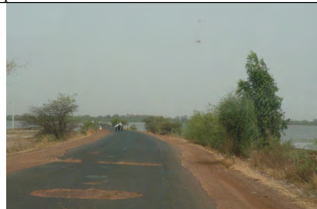
Etat de détérioration de la route nationale No. 4 La détérioration de la route s'avance d'une manière accélérée.
