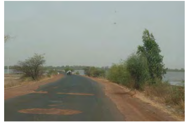
国道 4 号線の路面の損傷状況
