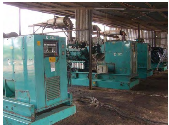
Tambacounda 発電所内部の状況
