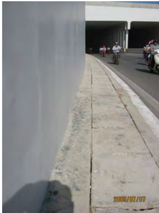
写真 IV.1-2 Kim Lien Underpass の側壁の「通り」が悪い状況
