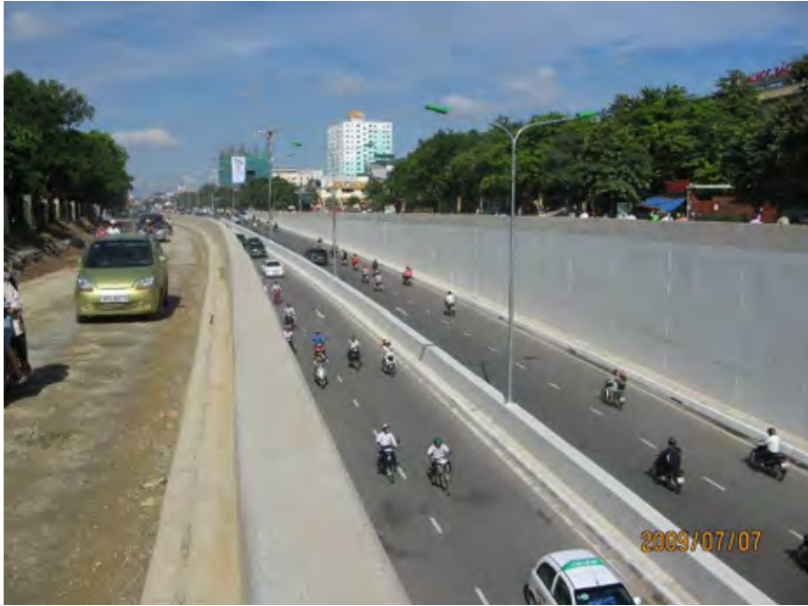
写真 IV.1-1 Kim Lien Underpass の壁面（平坦性が悪い）
