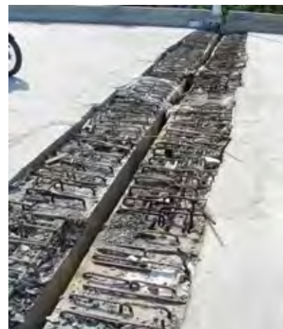
伸縮継手を設置するための「箱抜き部」：ごみが 多い。
