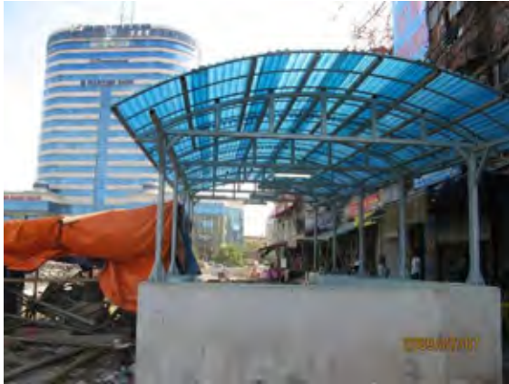
Kim Lien Underpass 横断地下道入り口の屋根： 建設業者の材料調達計画が悪く、品質の悪い材 料しか入手できなかったと PMU が非難していた。
