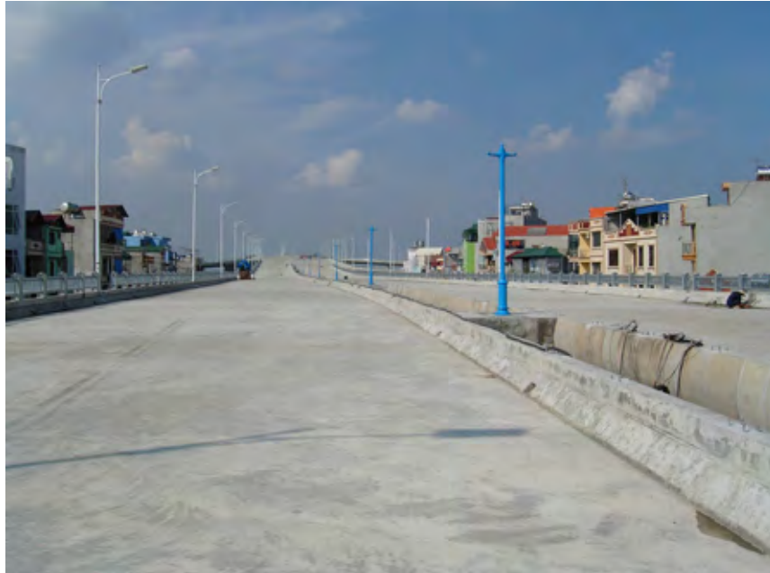
写真 IV.1-3 Vinh Tuy Bridge の床版の状況
