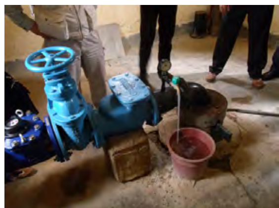
【ノルシンディ 地下水用深井戸】最近、吐出管に流量積算計が取付けられた。これにより、配水量の把握が可能になった。
