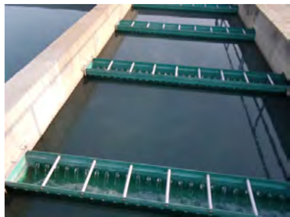
【ダッカ WASA グッドナイル浄水場】 横流式沈殿池末端の集水トラフ。外観を見た限りでは沈殿処理水の濁度は低く、比較的良好的な沈殿処理状態。
