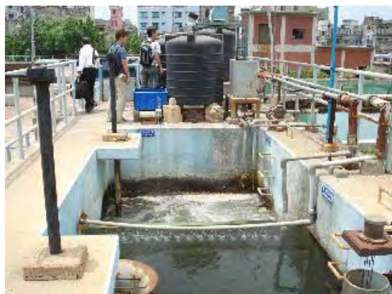
図 3.13-1 チャンドニガット浄水場 着水井
