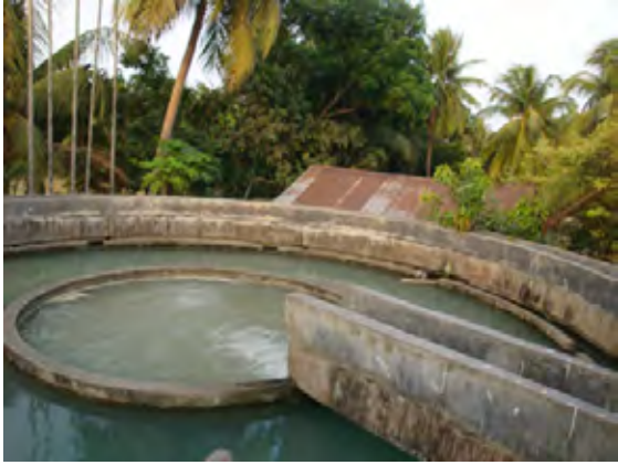
【チャンドプール（一般市庁）の表流水浄水場】 迂流式緩速攪拌沈殿池。池内の水は白濁しており、フロック形成、成長状態はあまり良好ではない。
