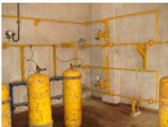
図 3.13-4 チャンドニガット浄水場 塩素ボンベ室
