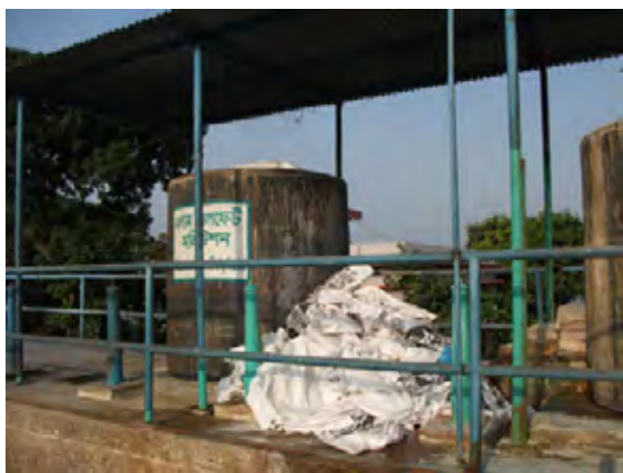
【ダッカ WASA グッドナイル浄水場】 硫酸アルミニウム設備。凝集剤として固形硫酸アルミニウムが使用されている。
