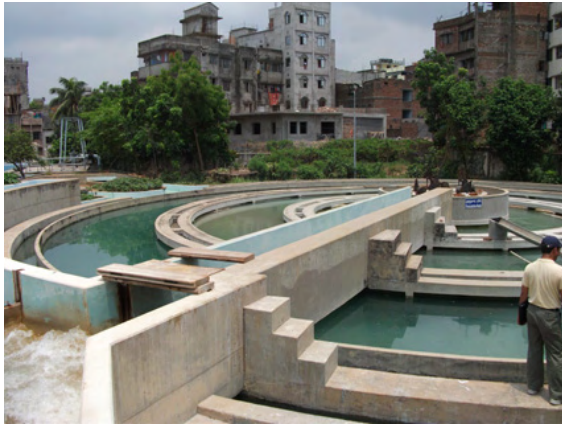
【ダッカ WASA チャンドニガット浄水場】 急速混和池と緩速混和池。水流利用によるフロック形成は良好である。
