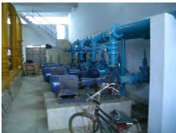
【ノアカリ（一般市庁）】水色は配水ポンプ施設で配水池から水を吸い込み、ポンプの台数を変えて配水している。
