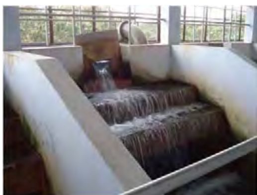
図 3.13-6 ノアカリ 鉄除去施設 (酸化水路)
