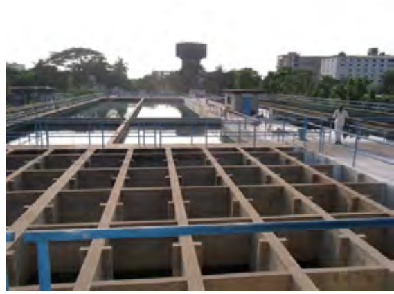
【ダッカ WASA グッドナイル浄水場】 迂流式フロック形成池、沈殿池全景。取水河川シタロッカ川沿いに浄水場がある。
