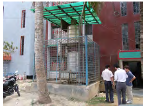
【ムラドナガール郡コミュニティ型砒素除去装置】CBO 管理により時間給水が行われている。
