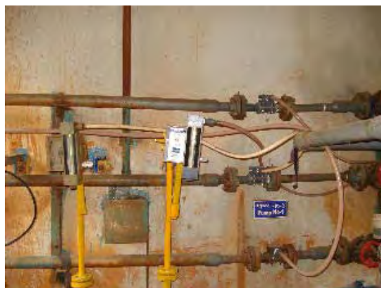
図 3.13-5 チャンドニガット浄水場 塩素注入機室
