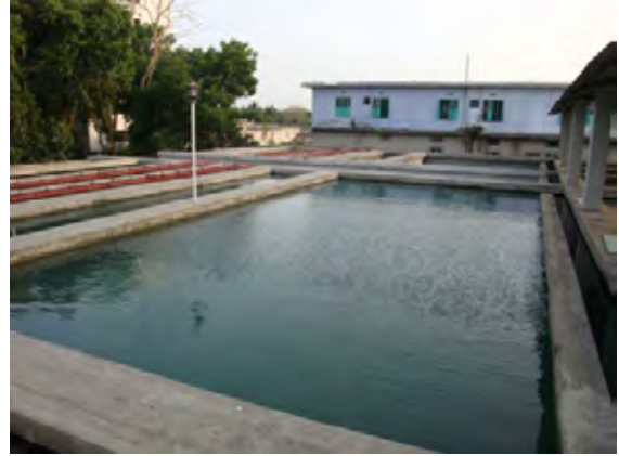
【チャンドプール（一般市庁）の表流水浄水場】 横流式沈殿池。
