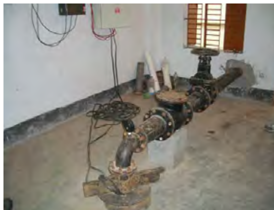
【ブラフモンバリア（一般市庁）の深井戸施設】配水量測定のための流量計は取り付けられていないが、近く取り付けるとのこと。
