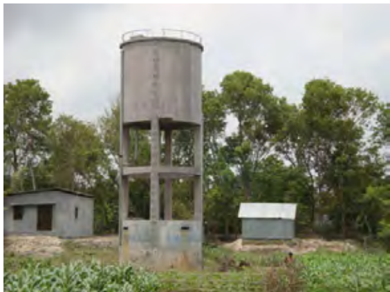
【チャンドプール県カチュア郡の高架水槽】地下水を井戸ポンプで揚水し、高架水槽経由で配水される。
