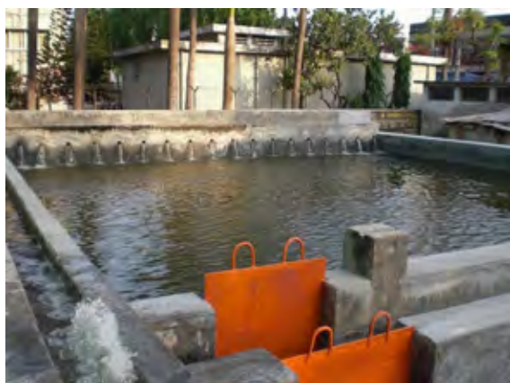
【クルナ WASA 沈殿池の様子】現在、ろ過池は故障のため使用されず、沈殿処理水が配水される。
