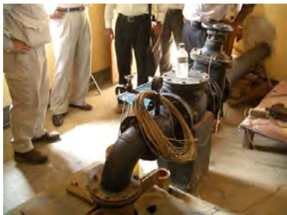
【ガジプール（一般市庁）の井戸施設】メンテナンスの状態は良好で、運転記録も毎日採取されている。井戸水位計も常備している。
