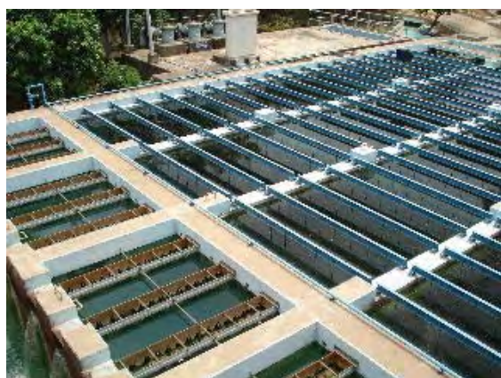
図 3.13-3 チャンドニガット浄水場 傾斜沈殿池
