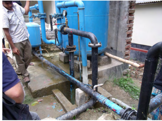
【ケラニガンジ県ファナガール村 地下水を水源とする水道施設】水色の水槽は鉄除去ろ過施設。
