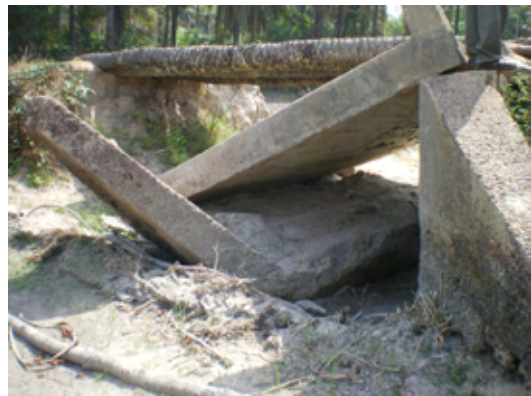
雨期で崩壊したカルバート
