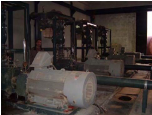
RDAWSSA:同プロジェクト;送水ポンプ
