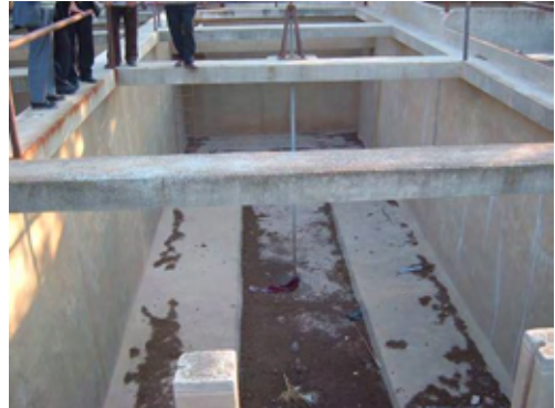
HAMA: Alkantra 新浄水施設予定地の沈殿槽
