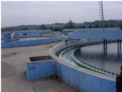
HOMS: 下水処理場のエアレーション池
