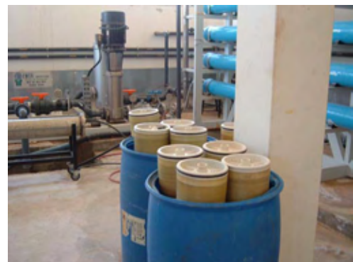
HAMA: 同浄水施設の洗浄中の RO 膜
