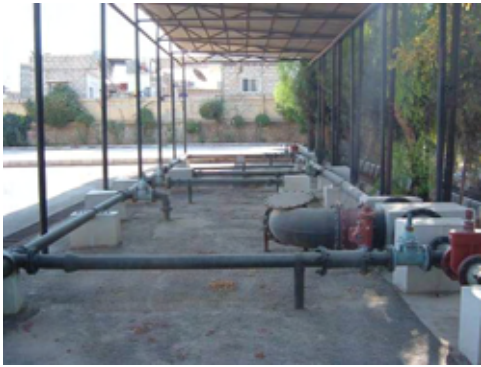
DAWSSA:漏水研修所 研修用配管・付属品施設
