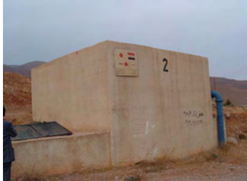
RDAWSSA:同プロジェクト;配管ルート沿い調圧槽
