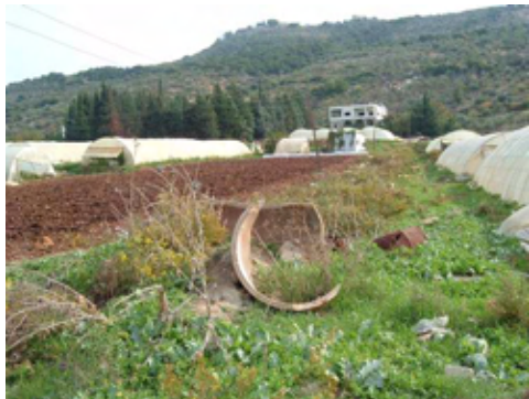
LATTAKIA: 第2導水管ルートと破断した ACP 配管
