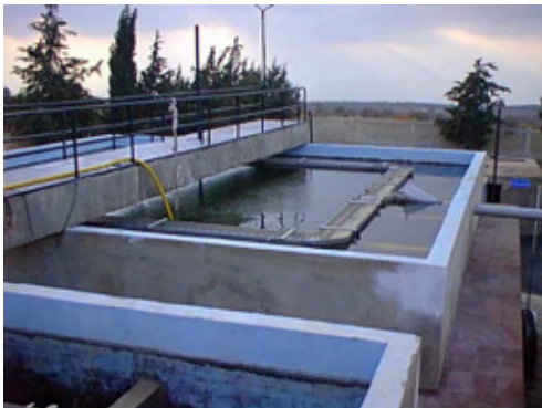
SWEIDA: 凝集沈殿池 (Sud Al Room WTP)
