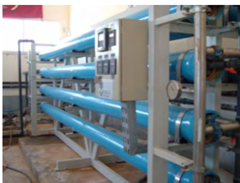
HAMA: Saboura RO 浄水施設の RO 膜部
