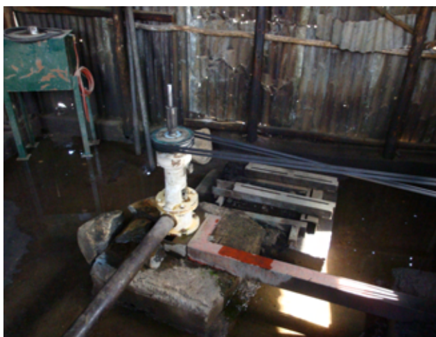
South Gonder No.19: Kimerdengaye 井戸施設 (モノ・リフトポンプによる揚水)
