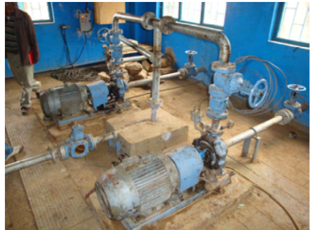
East Gojam No.6: Bichena 加圧送水ポンプ (集水池から配水池へ送水)
