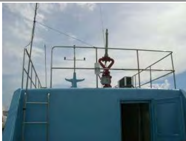
写真-6: 警備艇クラス III の放水器
