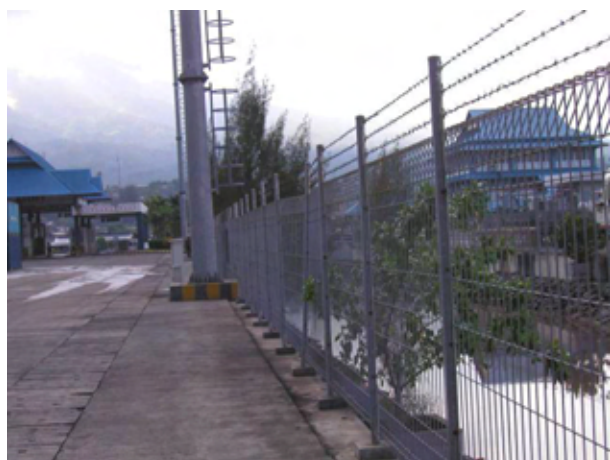
写真-5: 新港の固定フェンス
