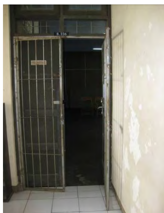
写真-3:B4棟2階の外国語学科LL教室入口。 格子とドアの双方に施錠可能。
