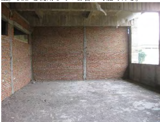
写真-15:LL 機材設置予定場所。
