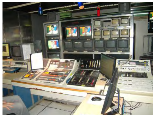
写真-14：マスタールーム。ここから編集された映像が総務省による整備予定のビデオ送出装置に出力される
