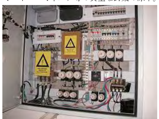
写真-14：屋内講堂に隣接して設置されている主幹盤（三相60A）。入力電圧はAC220Vで安定。
