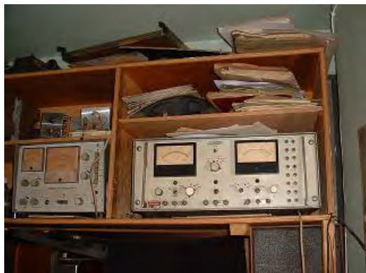
写真-11：30年以上に亘り使用している既存機材
