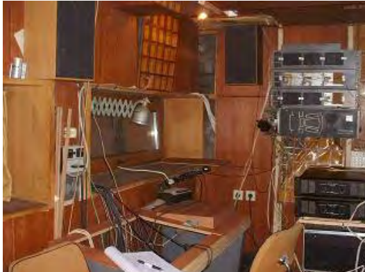
写真-6：音響調整室。現在はほぼ機材がないため外部機材を持ち込んでいる。主要機材の設置場所。
