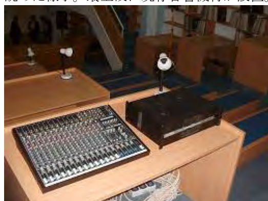
写真-4：屋内講堂に設置されている1998年に自己調達したミキサー。状態は良好。
