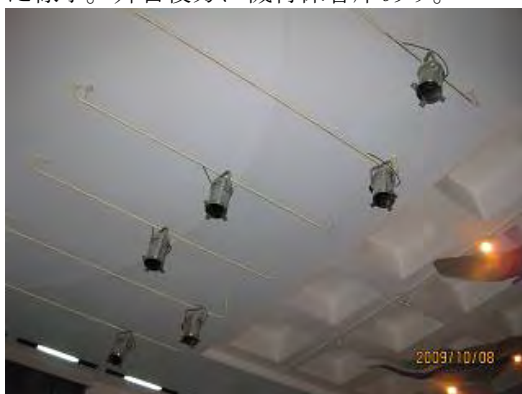
写真-5：屋内講堂天井の照明機材。電源オンオフだけの調光機能のないもの。
