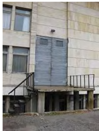
写真-22：機材搬入口。大型トラック横付け可能。
