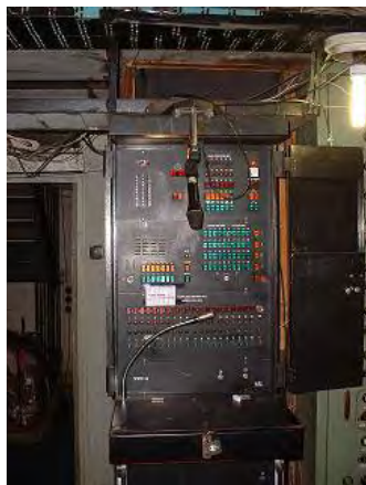
写真-9：舞台監督操作盤。有線式インターカムシステムが内蔵されているが満足に機能していない。
