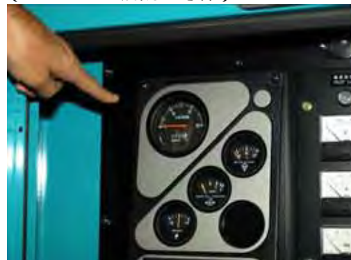
既存設置のディーゼル発電機（停電対策）
