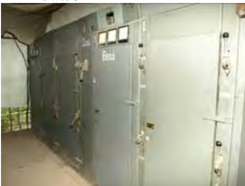
ディアコフ病院内のサブステーション
