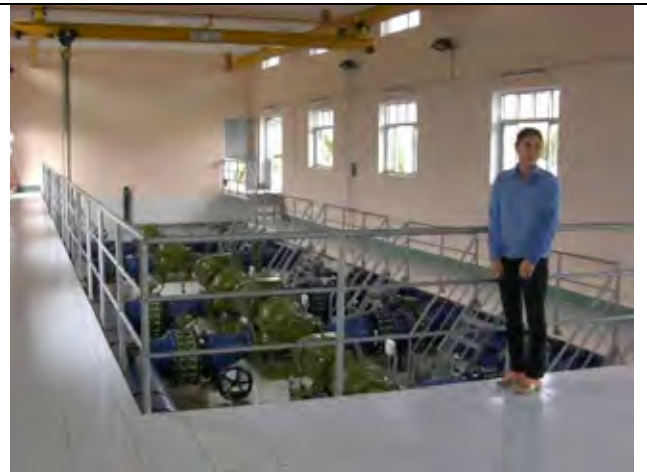
配水ポンプ場(同浄水場内)
