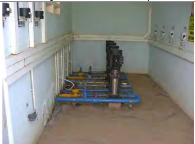
塩素注入室(同配水場内)
