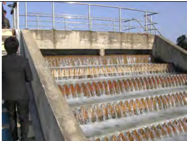
Gio Linh 浄水場、エアレーション施設 (原水:地下水、処理能力 15,000m 3 /日)
