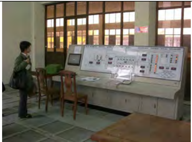
監視制御室(制御システム: Siemens PCS7) (Cau Do 浄水場)
