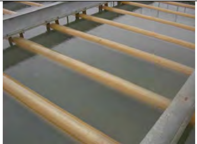
沈殿池(ハニカム型傾斜管式) (Cau Do 浄水場)
