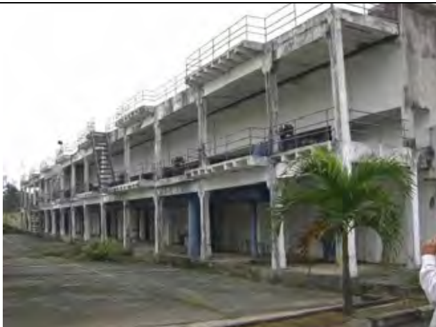
Hung Vinh 浄水場の内、処理能力 20,000m 3 /日のプラント (2階が沈殿池とろ過池、1階が配水池の2層構造)
