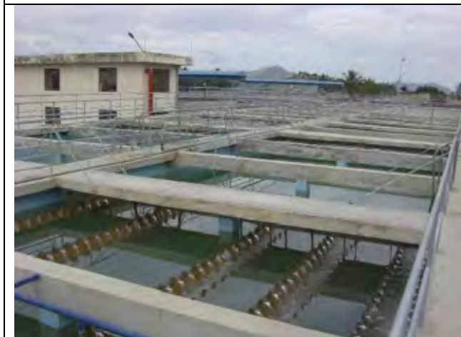
沈殿池(Vo Canh 浄水場)
