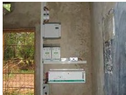
コントローラー、インバーター等の 資機材設置例（教室棟内）
