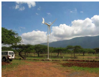
センター内に設置されている 風力発電用風車（訪問時は未接続）
