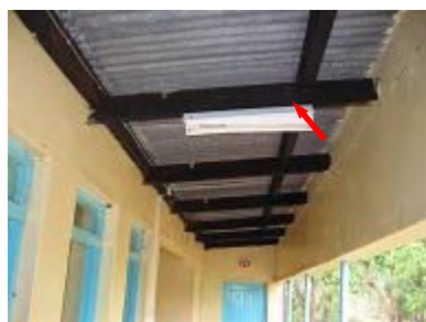
入院患者用厨房の外の面した廊下に設置された 夜間セキュリティー用の外灯 (20W 蛍光灯)
