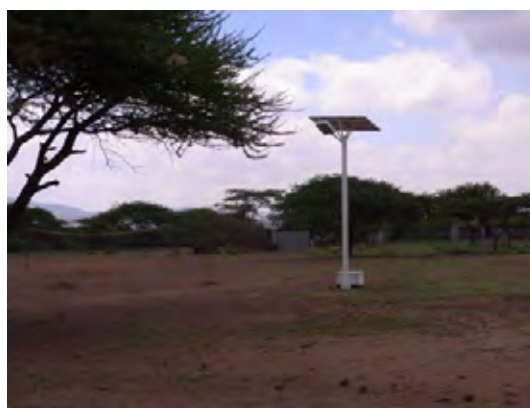
小学校に設置された太陽光発電
