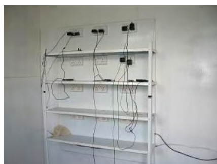
設備棟2に設置されている 携帯電話充電設備
