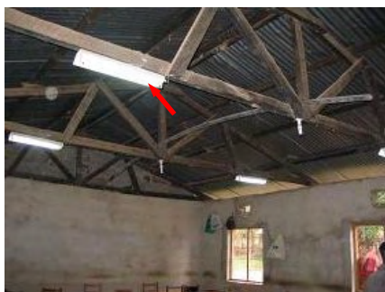
教室内部の照明（20W 蛍光灯）
