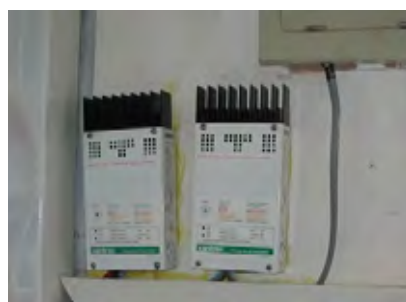
設備室内に設置されている チャージコントローラ（40Amp）
