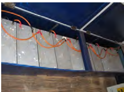
設備室内に設置されている蓄電池 （12V200Ah×18を24V200Ah×9 にして使用）
