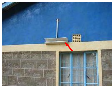
夜間セキュリティー用の外灯（20W 蛍光灯）
