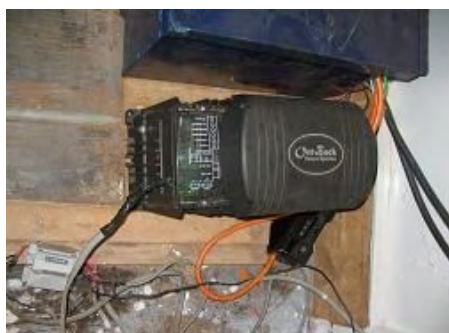
設備室内に設置されている インバーター
