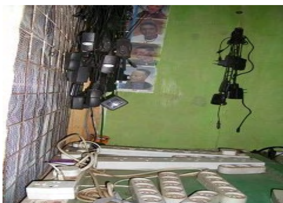
コミュニティセンター内の バッテリーチャージング施設
