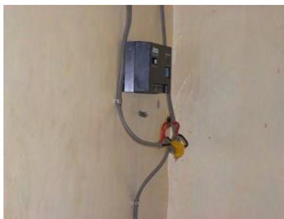
太陽光パネルからのケーブルはコントローラーと接続されておらず、負荷と直接接続されている
