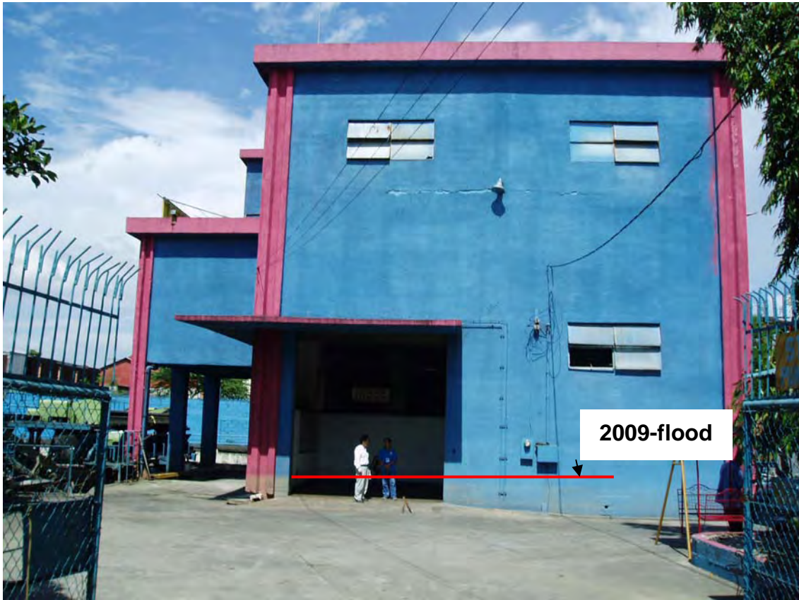
写真-1 サンタ・クララ ポンプ排水機場 (メトロマニラ)
