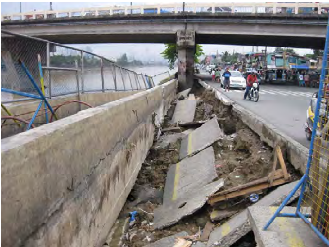
写真-6 台風オンドイで雨水閉塞により被害を受けた道路暗渠構造物等 (マンガハン放水路)
