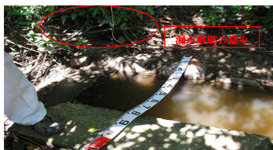
導水管（吐口部）
