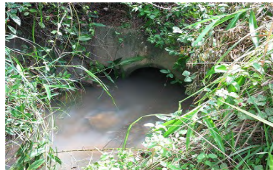
導水管（吐口部）
